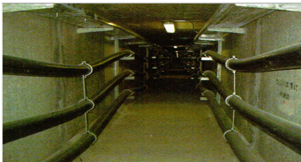
Ligne 400 000 V en tunnel
