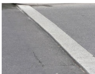
Avant : détail d'un raccord non traité entre la chaussée et le plateau, générant un bruit impulsionnel.
